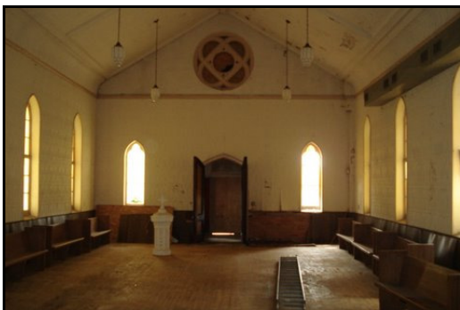
Внутренний вид церкви: нужно разобрать пол и отреставрировать фундамент. Церковь нуждается в отоплении, охлаждении, водоснабжении и электричестве.
